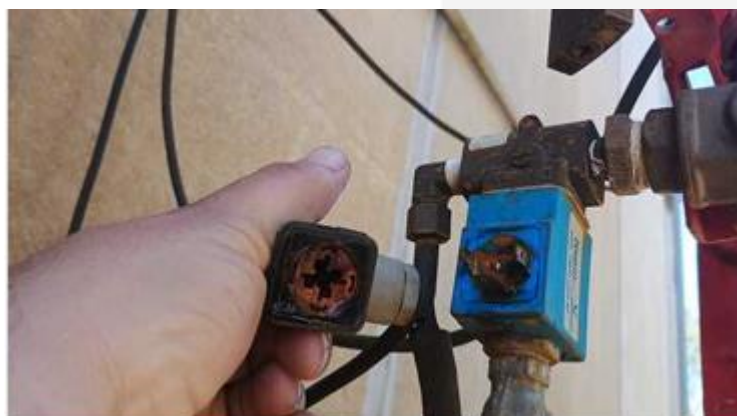
Foto 18: Necessário a troca da solenoide da VGA2.
