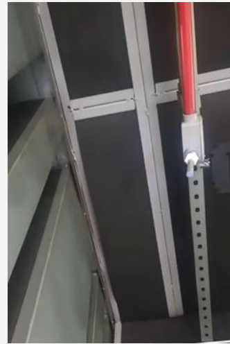
Foto 12: Detector de calor sem atuação
