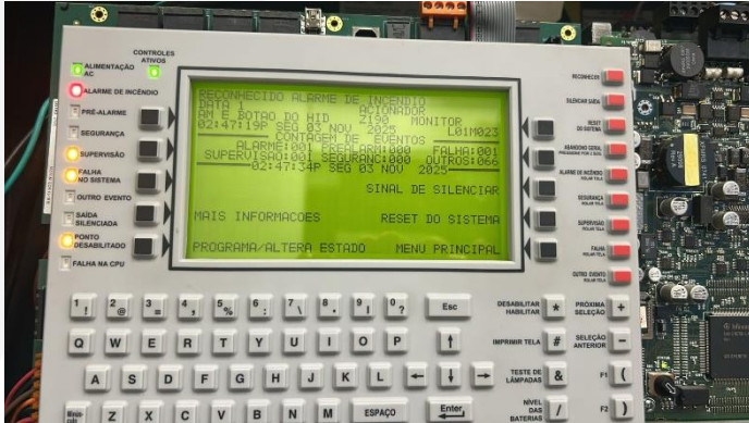
Foto 05: Central de alarme de incêndio sendo acionada
