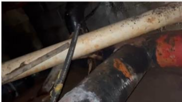
Foto 17: Tubulação parte de baixo. Recomendamos revitalização das tubulações
