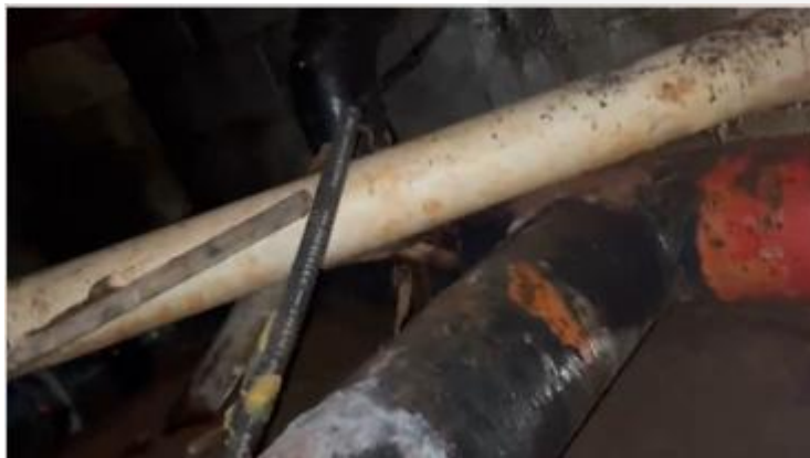
Foto 17: Tubulação parte de baixo. Recomendamos revitalização das tubulações
