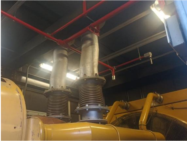
Foto 11: Sala de Geradores 05 com detector de calor não atuando
