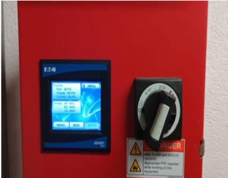
Foto 15: Foi realizada a calibragem do painel da bomba jockey.
