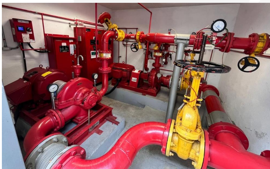
Foto 04: Case de Bomba do local
