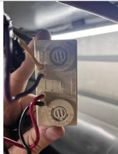
Foto 16: Módulo gerador L05M033 esta sem funcionar, necessário a troca.
