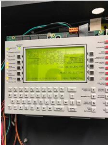
Foto 21: Sirenes e modulos desativados.
