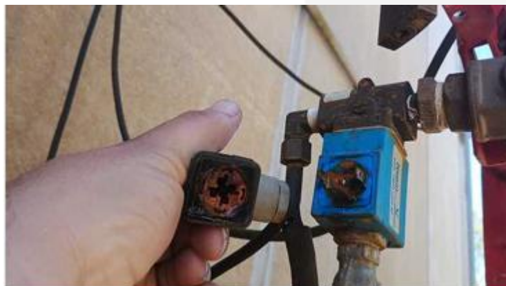
Foto 18: Necessário a troca da solenoide da VGA2.
