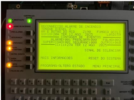
Foto 05: Central de alarme de incêndio sendo acionada
