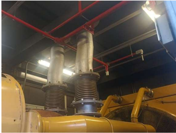
Foto 11: Sala de Geradores 05 com detector de calor não atuando
