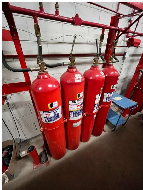
Figura 1. Modelo de baterias de CO2 existente
