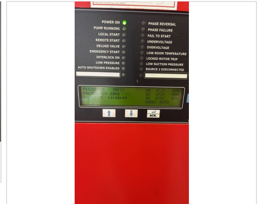
Painel apresentando 95psi, porém pressão atual 130psi Necessário recalibração
