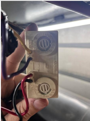
Modulo gerador L05M033 esta sem funcionar, necessário a troca.
