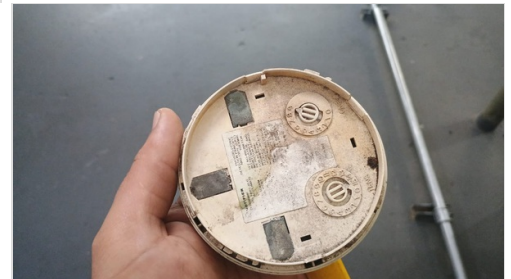
SENSOR DE FUMAÇA TANQUE DIESEL COM DEFEITO.
