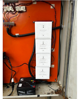
FOI REALIZADA A TROCA DO MODULO DO L05M022.
