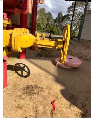
VALVULA DE GOVERNO DA VGA ESTA GOTEJANDO, SERA NECESSARIO A MANUTENÇÃO.
