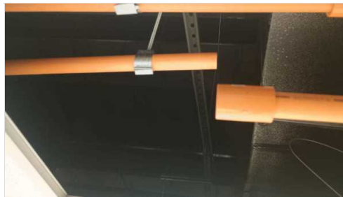
TUBULAÇÃO DO VESDA SOLTA
