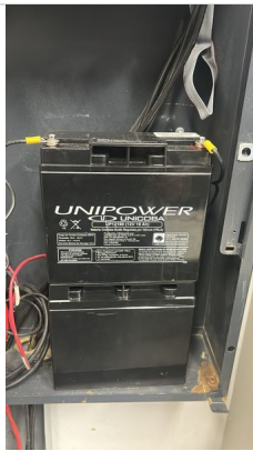
NECESSARIO A TROCA DAS BATERIAS
