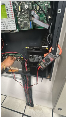
TENSAO DAS BATERIAS (FLUTUAÇÃO)
