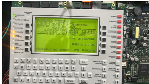
MODULOS DESABILITADOS PARA MANUTENÇÃO.
